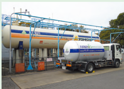
LPガスストレージタンクとバルクローリー車
